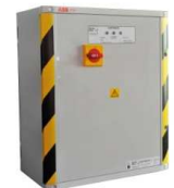
Armoire d'alimentation et de secours
